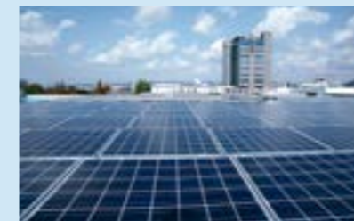
太阳能发电设备的引进 集团总输出能量2,180kW
