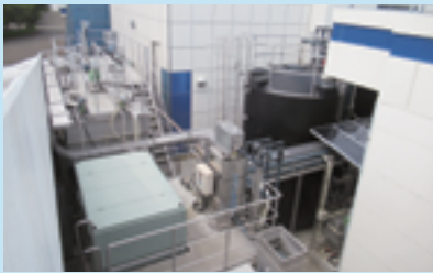
通过废水处理设备进行合理的废水处理
